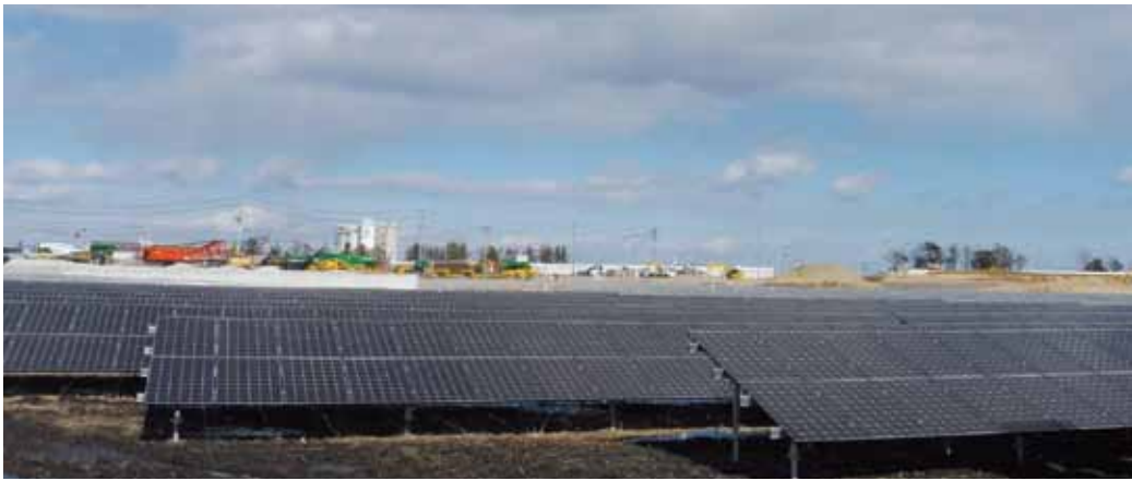
▲尾浜地区のソーラーパネルとその向こうに見える建設中の堤防
